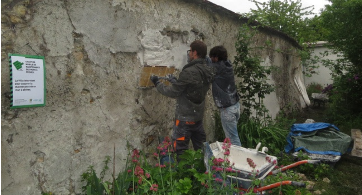
Loic et Chales-Louis, maçons envoyés pas la mairie, retapent les murs du site. Le 10/05/2016 - 20minutes
